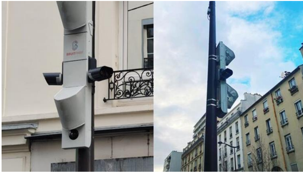
เรดาร์ตรวจจับเสียงได้ติดตั้งบนเสาไฟถนนในเขตที่ ๒๐ ทางตะวันออกของปารีส (@David_Belliard/ทวิตเตอร์)
